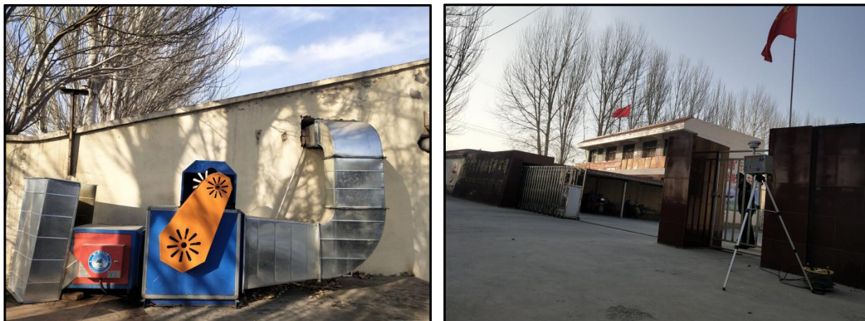
图 7-2 项目油烟净化器及现场大气监测图
