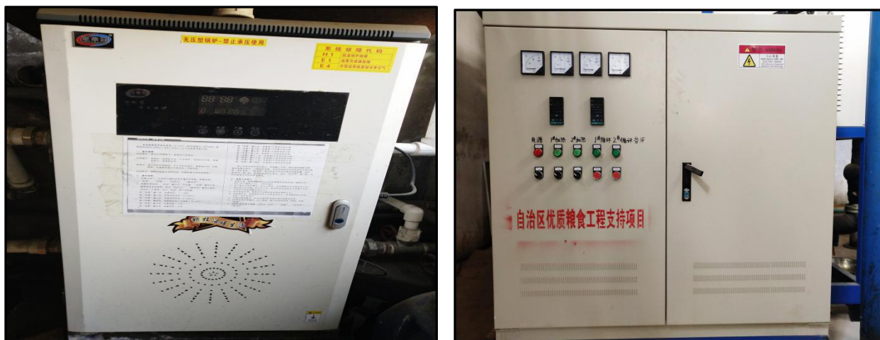
图 7-3 项目电锅炉现状图
